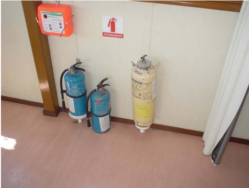
Gambarajah 4: Pemadam Api jenis mudah alih di atas kapal
